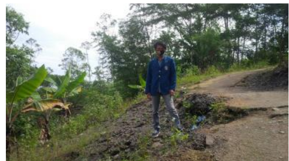
Gambar 4. Kerusakan jalan akibat gerakan tanah.
