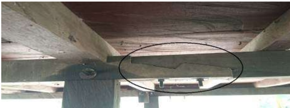
Gambar 15. Sambungan Bibir Miring Berkait dengan Pengunci Baut pada Gelagar Bawah Rumah Panggung
